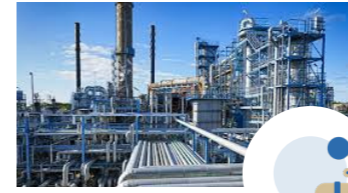
플랜트 배관 변형률, 균열, 이상진동
