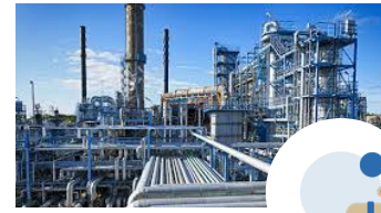
플랜트 배관 변형률, 균열, 이상진동
